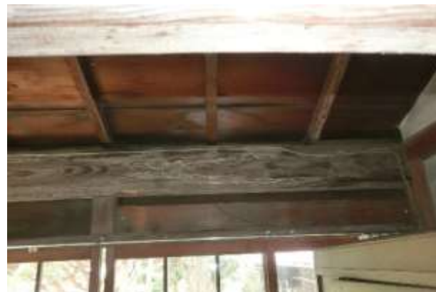
梁の蟻害又は腐食
