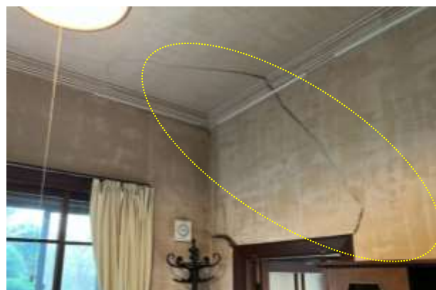
応接間の壁面に入るクラック
