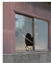
窓が割れた 管理不全空家
