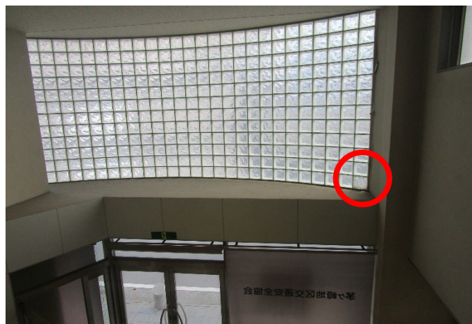
2階吹き抜けガラスブロック割れ
