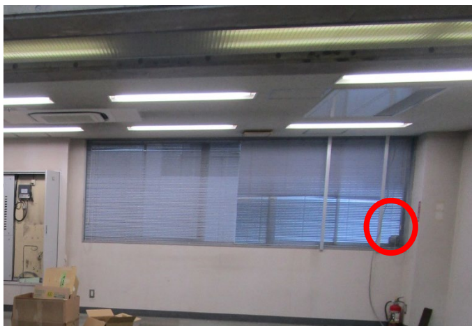
1階窓ガラス割れ
