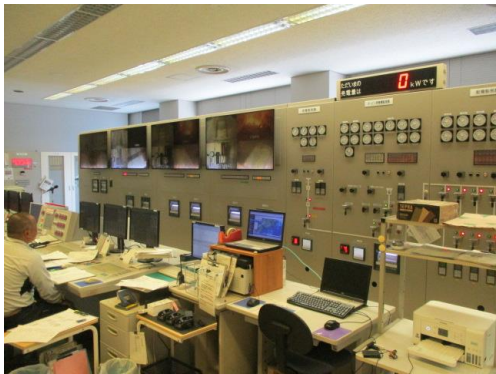
中央制御室で、施設内の機器の監視や操作を行います
