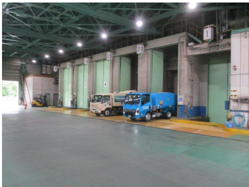
搬入されたごみは、ここでごみピットに投入されます
