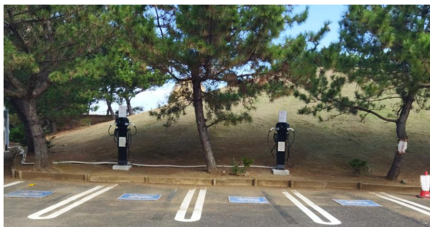
（茅ヶ崎公園に設置したEV用普通充電設備）
