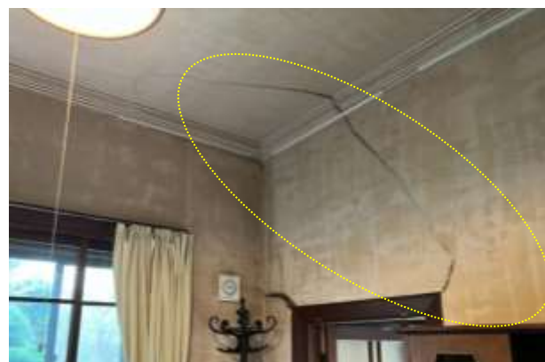
応接間の壁面に入るクラック
