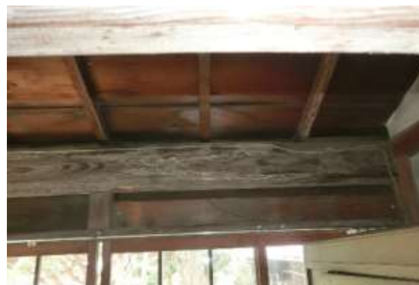
梁の蟻害又は腐食
