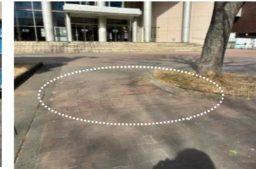
樹木の根上りによる舗装の凸凹
