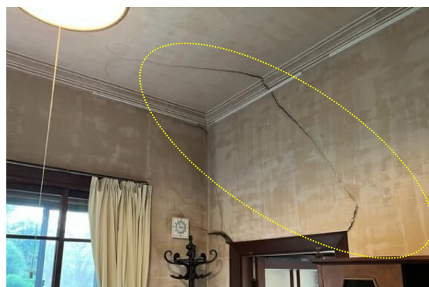
応接間の壁面に入るクラック
