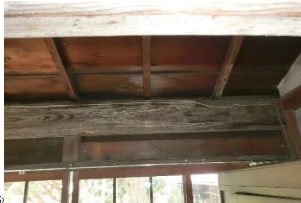
梁の蟻害又は腐朽
