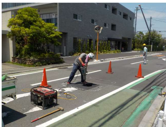
道路陥没対応
