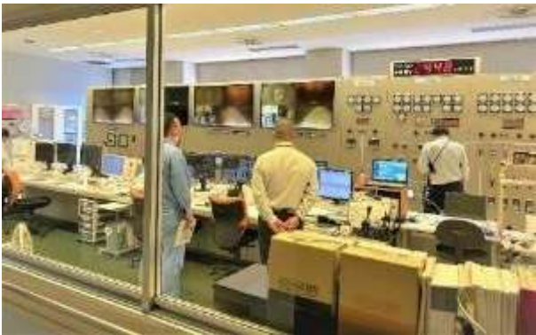
環境事業センター（中央制御室）
