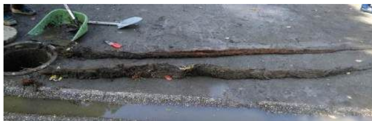
排水路の管路から取り出した根（長さ3メートル）
