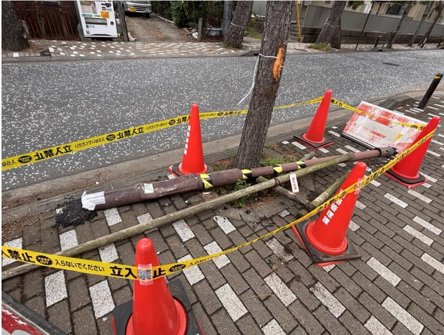
令和6年10月29日確認時 事故現場
