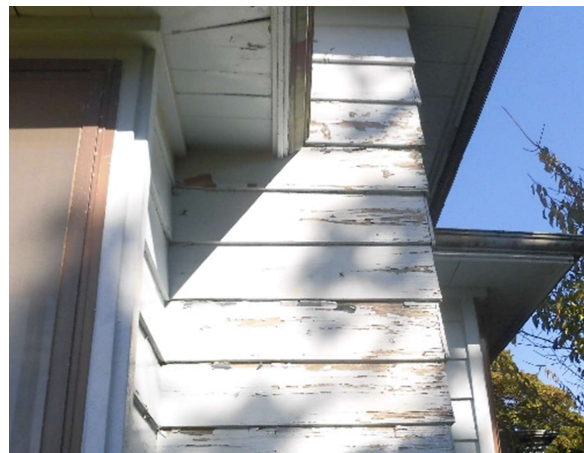
外壁のはがれ (→外壁の塗り替え)
