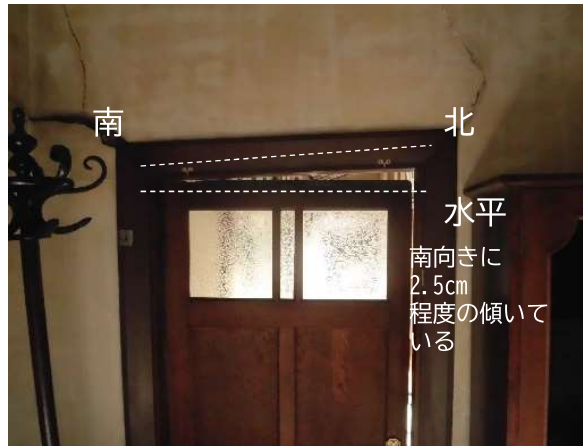
応接間の傾き (→応接間の沈下解消)
