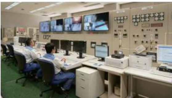
環境事業センター（中央制御室）
