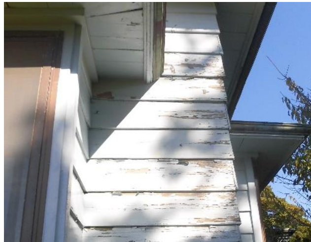
外壁のはがれ （→外壁の塗り替え）
