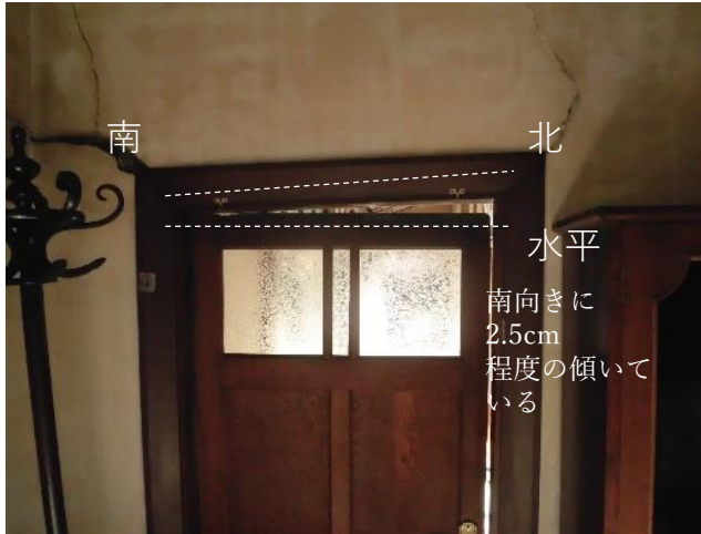
応接間の傾き （→応接間の沈下解消）
