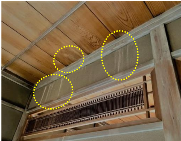
1階天井の雨漏り （→屋根部の雨漏り箇所補修）
