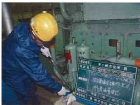
ポンプ用エンジンの点検の様子
