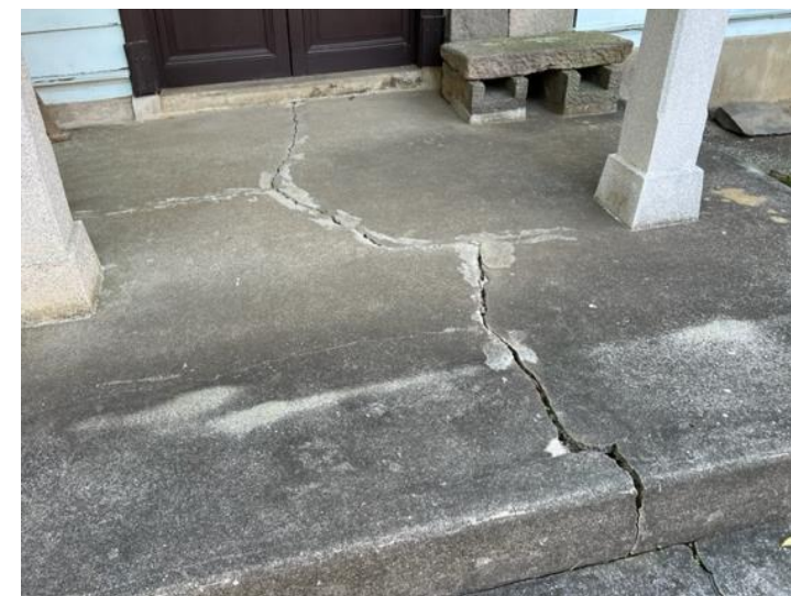
玄関ポーチ基壇のクラック (→基壇の補修)
