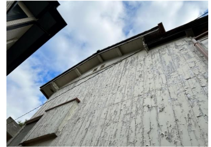
外壁塗装のはがれ (→塗り替え)
