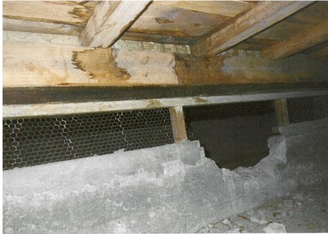
無筋コンクリート・基礎の欠損 (→内基礎の整備)
