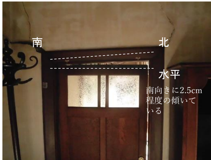
応接間の傾き (→応接間の沈下解消)
