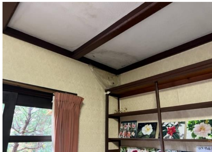
1階天井の雨漏り (→天井材・雨漏り箇所の補修)
