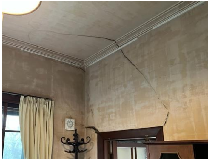
応接間の壁面に入るクラック (→内壁の補修・漆喰の塗り替え)
