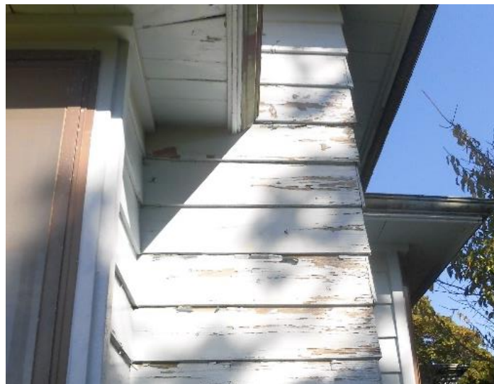
外壁のはがれ (→外壁の塗り替え)
