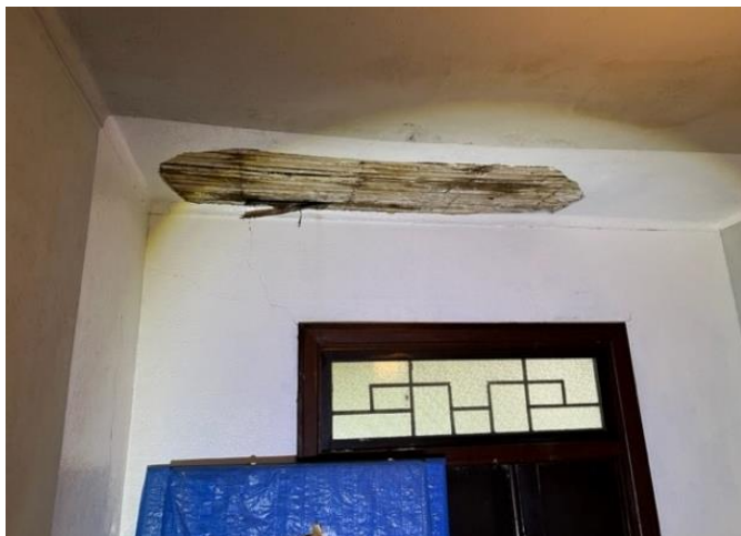
1階玄関天井の雨漏り・天井材の欠落 (→天井材・雨漏り箇所の補修)
