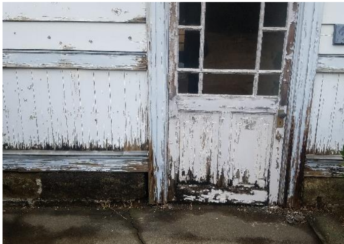
外壁の腐朽 (→外壁材の一部やり替え)
