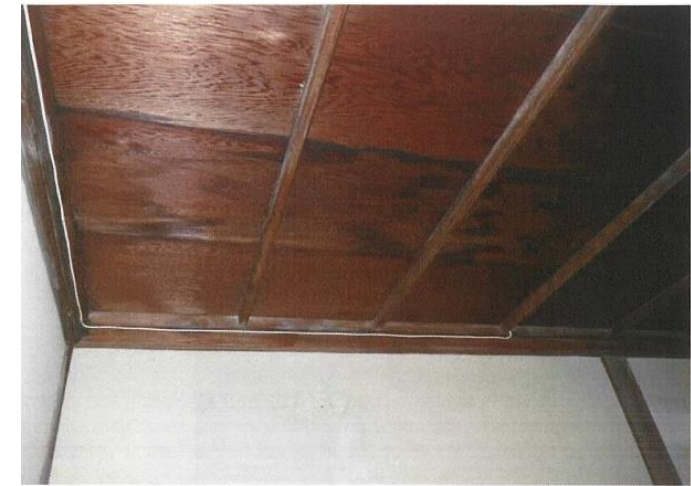
2階天井の雨漏り (→天井材・雨漏り箇所の補修)
