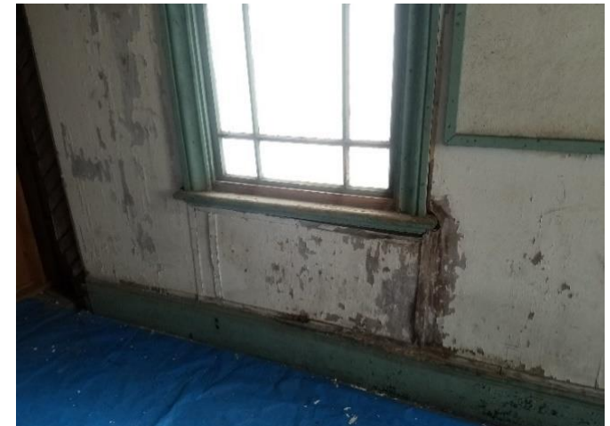
内装の腐朽・雨漏り？ (→外壁材の一部やり替え)
