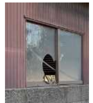
窓が割れた 管理不全空家
