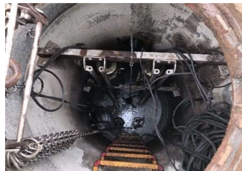
写真 4.5 サザンビーマンホールポンプ
