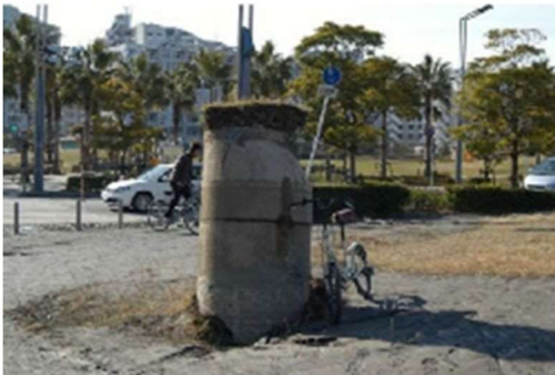
写真 4.1 液状化によるマンホール浮上
