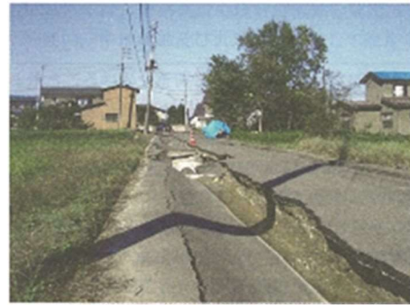
写真 4.2 地震による管路埋設部の沈下
