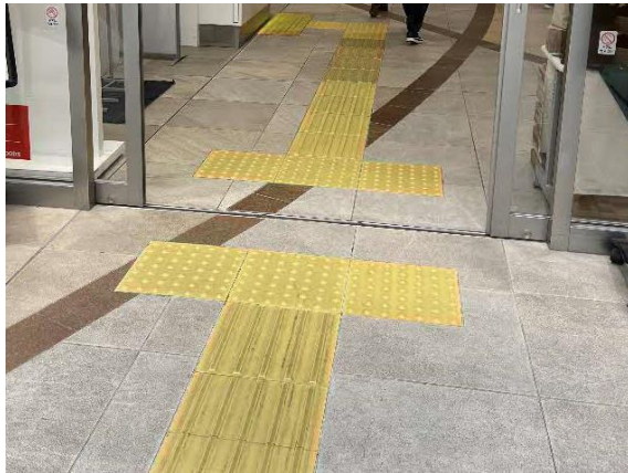
駅自由通路から出入口、インフォメーション(有人)まで視覚障がい者誘導用ブロックを連続的に設置【茅ヶ崎ラスカ】
