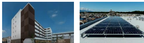
市営小和田住宅外複合施設の太陽光発電設備
