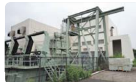
柳島ポンプ場
