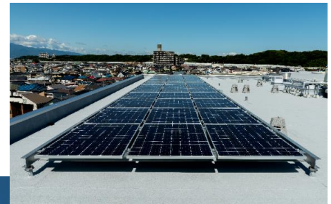
太陽光発電設備
