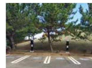
EV用普通充電設備 (茅ヶ崎公園)
