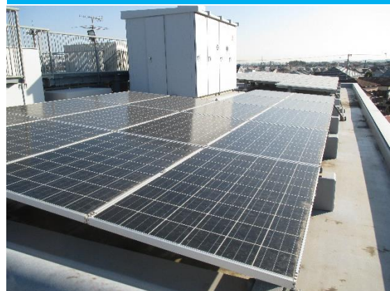
太陽光発電設備(松浪コミュニティセンター)
