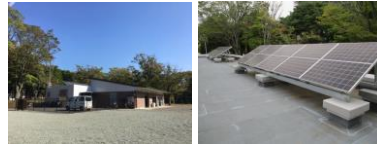
中央公園管理棟の太陽光発電設備
