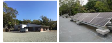
中央公園管理棟の太陽光発電設備
