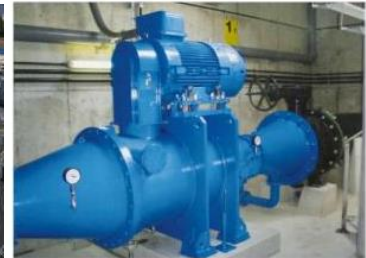
神奈川県 小水力発電設備(芹沢) 出典:神奈川県HP
