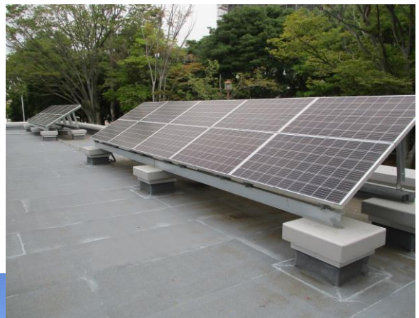
太陽光発電設備
