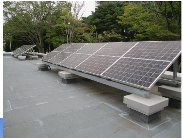
太陽光発電設備
