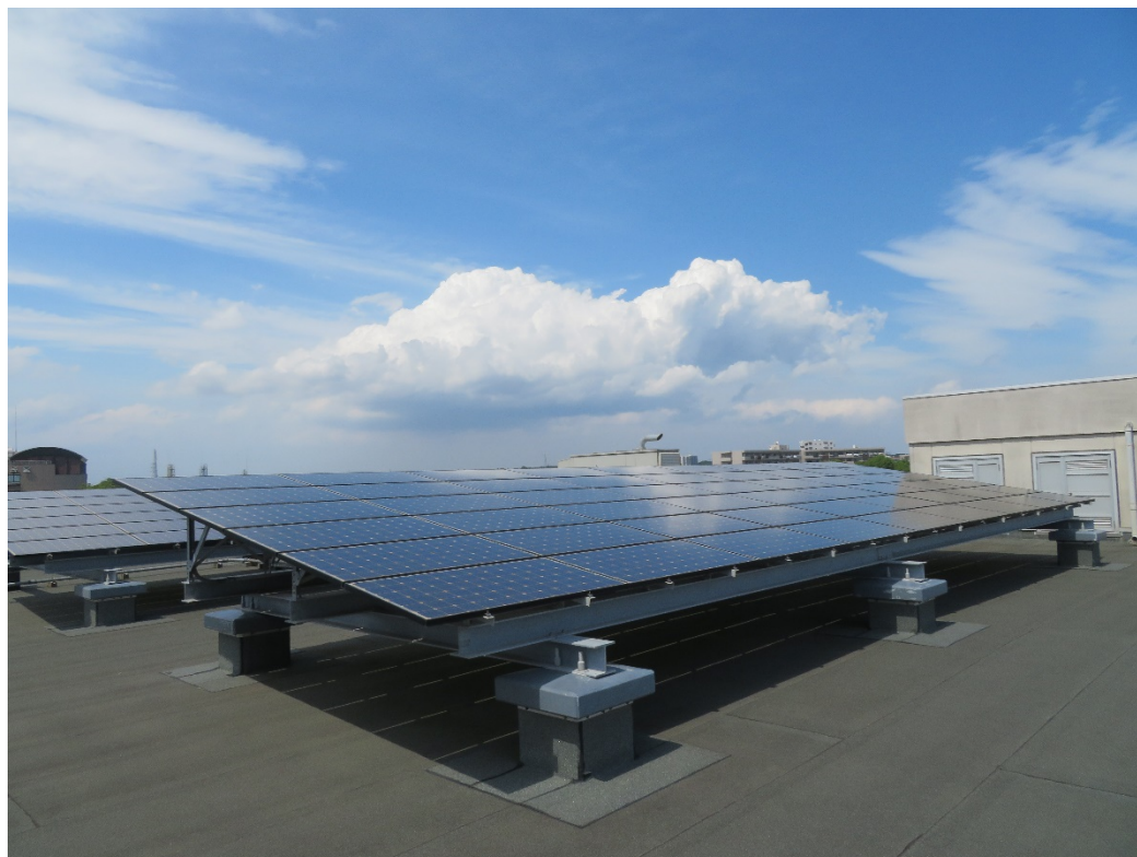
10. 太陽光パネル (立体駐車場屋上)
