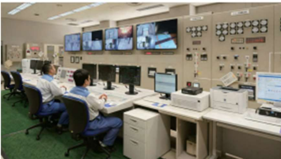
環境事業センター（中央制御室）
