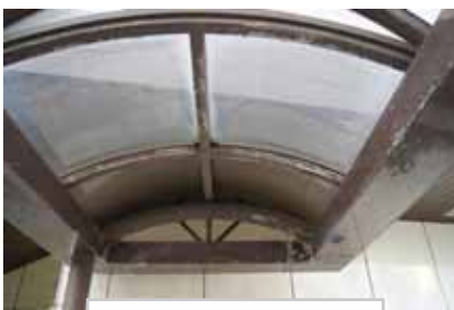
構造物の劣化、損傷
