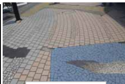
タイルの劣化、損傷
