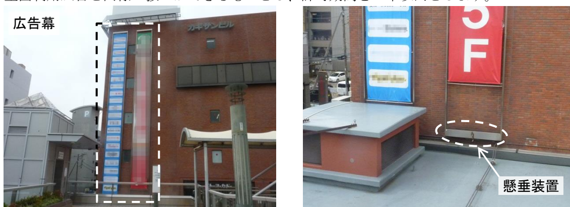
写真-3 懸垂装置により掲出された広告幕例
