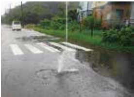
排水があふれるマンホール
