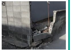
地震により倒壊した塀
