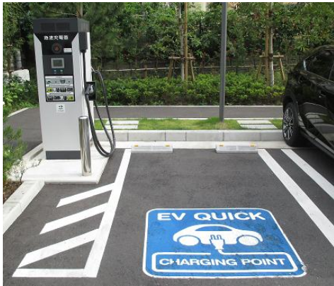
市役所に設置された急速充電器
