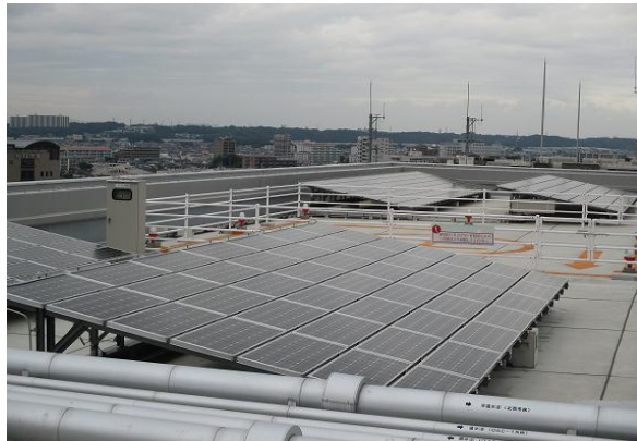
市役所に設置された太陽光発電設備(30kW)
