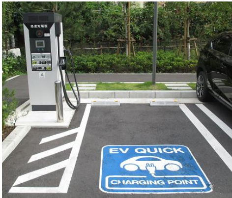
市役所に設置された急速充電器
