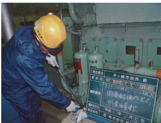
ポンプ用エンジンの点検の様子
