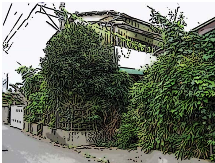
樹木が繁茂している空き家
