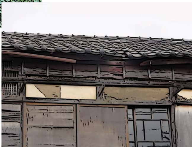
外壁・軒が腐朽した空き家
