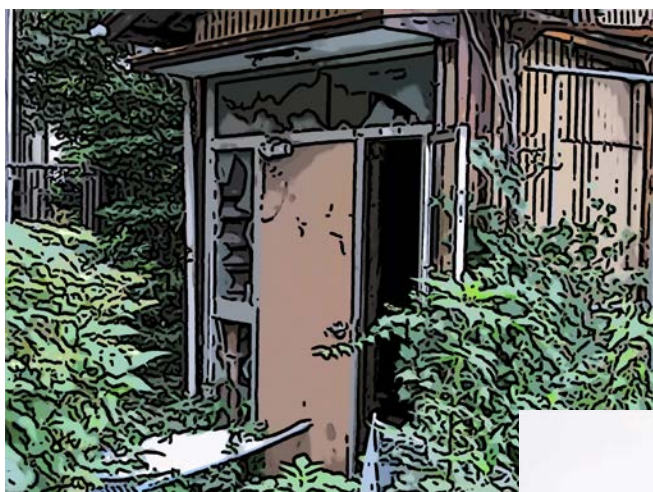
出入口が腐朽した空き家
