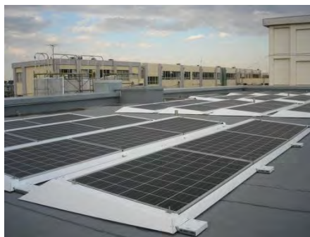
太陽光発電設備(10kW)
