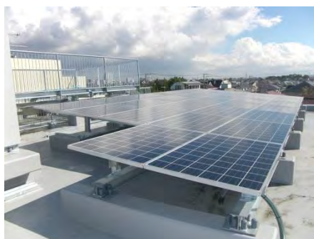
太陽光発電設備(10kW)
