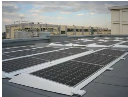
太陽光発電設備(10kW)
