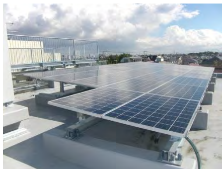
太陽光発電設備(10kW)
