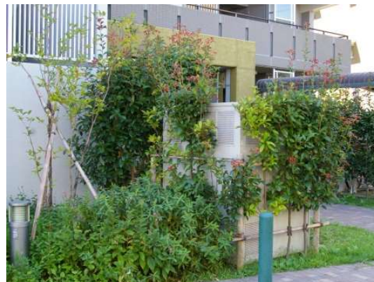
設備をみどりで修景している例 (藤沢市 コンフォール藤沢)
