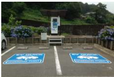
電気自動車用充電スペース
