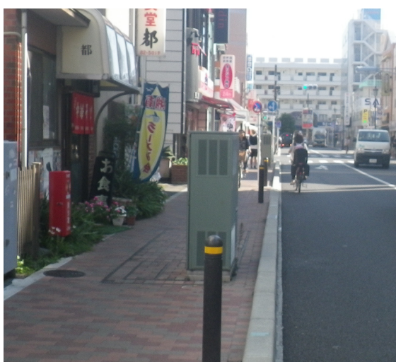
図 6-1 地上変圧器の整備事例（茅ヶ崎市）
