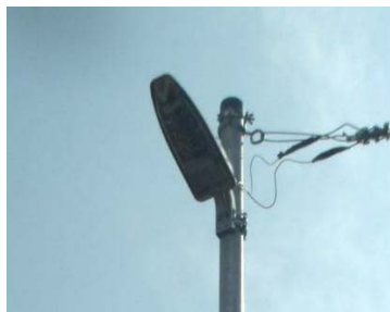
LED灯具を導入した防犯灯
