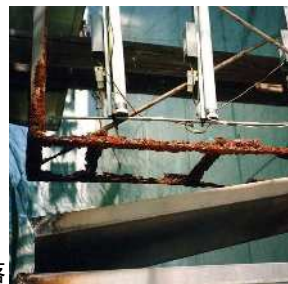
袖看板の底部脱落
