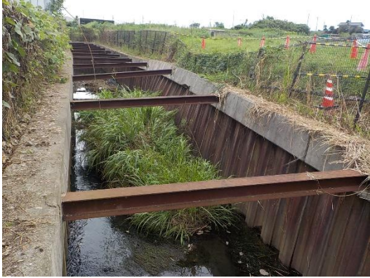
(護岸損傷状況写真)
