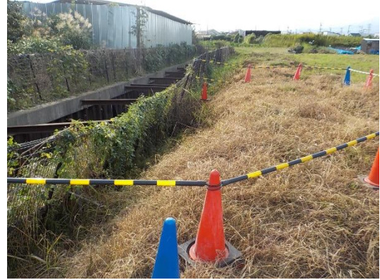
(護岸損傷状況写真2)
