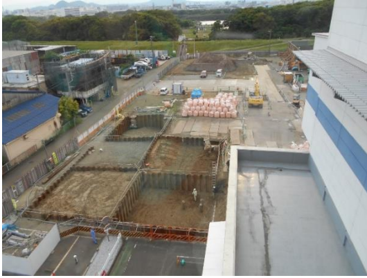
(汚染土壌区画状況)
