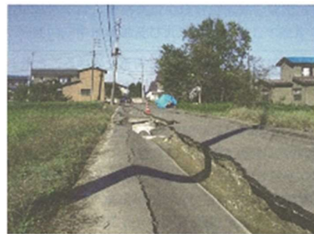
写真 4.2 地震による管路埋設部の沈下
