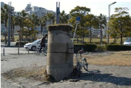
写真 4.1 液状化によるマンホール浮上
